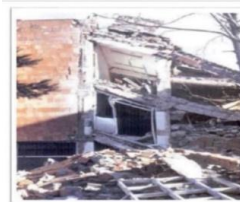
Gambar 1. Bangunan prefabrikasi roboh 1988, Armenia
